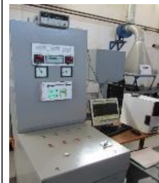
Noile standuri de încercări realizate cu ajutorul echipamentelor achiziționate prin proiect, utilizate pentru aplicarea în practică a noilor metodologii de testare a cablurilor electrice conform standardelor și normativelor
